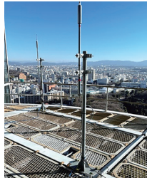
基地局アンテナ
