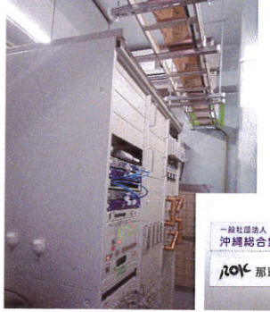
局舎内に設置された送信設備
