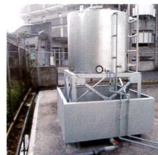
増設したタンク
