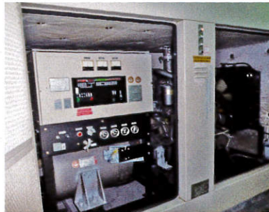
発電機の運転状況
