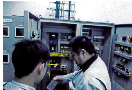
(一財)沖縄電気保安協会による点検
