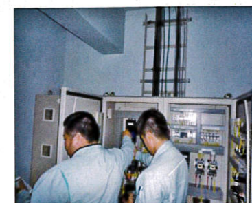
商用電源の切断
