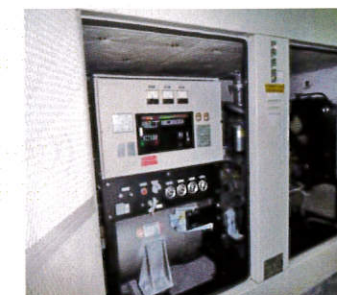
非常発電機が自動的に起動
