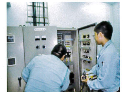
ブレーカー等自動切り替えの点検
